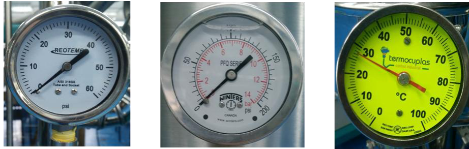
Figura 13. Indicadores. a) y b) manómetros. c) Termómetro bimetálico.
