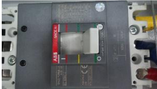
Figura 4 Totalizador de la PLANTA.
