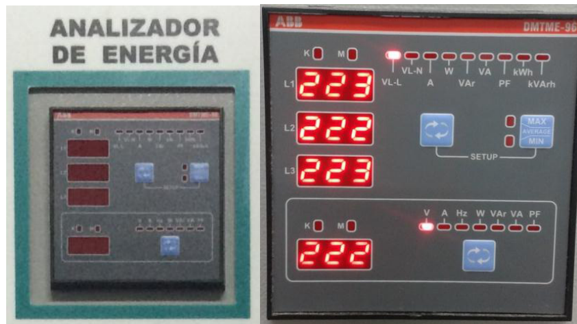
Figura 11. Medidor de Energía de la PLANTA.
