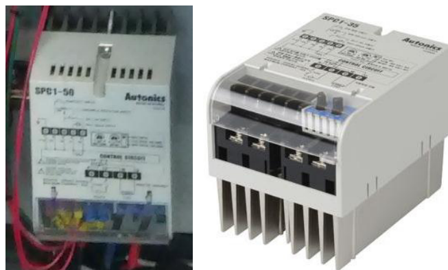
Figura 10. Dispositivo controlador de potencia.
