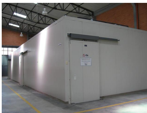
Imagen 16: Cuarto Frío. http://www.andesexport.com/spanish/Installations/Installations.html
