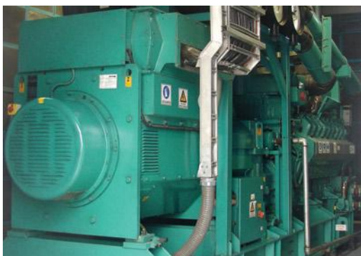
Imagen 10.1. Planta cogeneradora de la casa Cummins Power Generation Inc. Ubicada en Pastas Doria: Mosquera – Colombia
