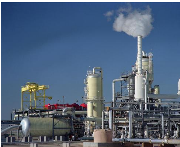
Imagen 3: Gas Natural http://portal.gasnatural.com/servlet/
