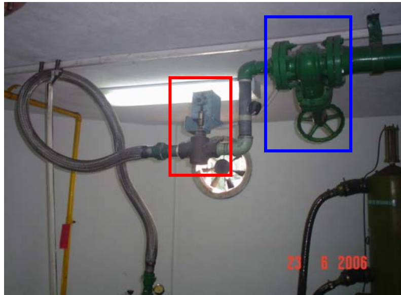
Figura 19. Disposición de las Válvulas de Control de Flujo del Dinamómetro
