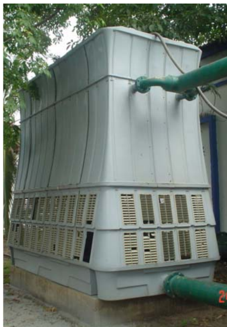
Figura 10. Torre de enfriamiento del banco de pruebas de motores de Cotecmar
