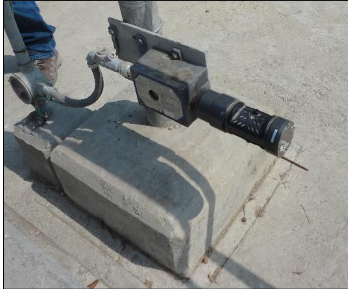
Figura 7. General Monitor. Detector de Gas instalado.
