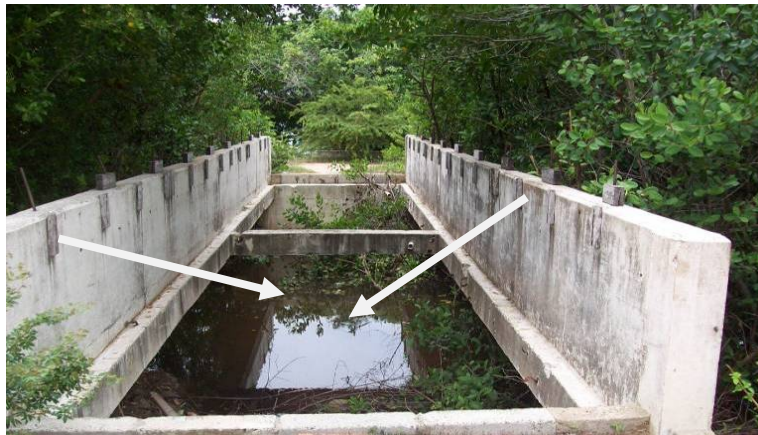
Figura 25. Puente interno en completo deterioro
