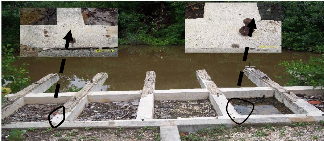
Figura 26. Muelles atacados por la corrosión
