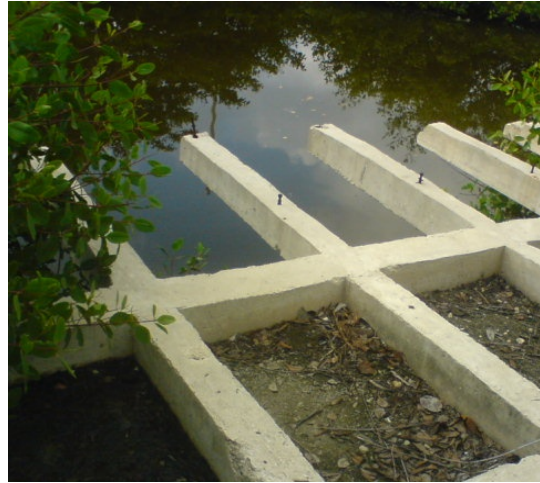
Muelle en mala condiciones
