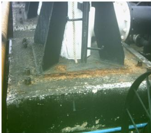
Figura 6: Bases brazos cargue deterioradas
