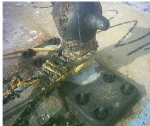
Figura 7: Bitas Amarre Buques deterioradas
