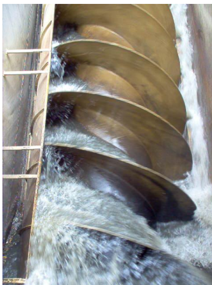
Figura 2-4. Captación y elevación del agua en la PTAR. Tomado del informe sobre el Proyecto de Saneamiento del Río Bogotá (PSRB).
