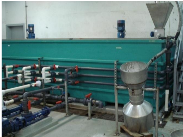
Figura 2-7. Tanque de preparación de polímero.
