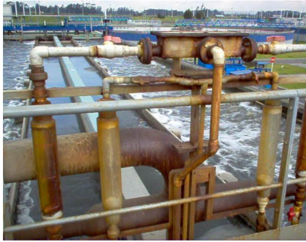
Figura 2-5. Dosificación Cloruro Férrico. Tomado del informe sobre el Proyecto de Saneamiento del Río Bogotá (PSRB).
