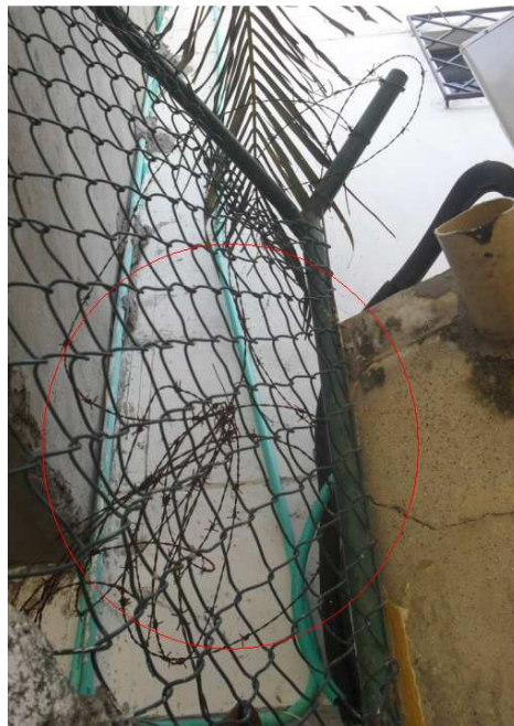
Figura 13. Canalizaciones para los equipos de A.A.
