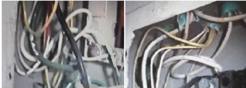
Figura 10. Insuficiencia de espacio para maniobrabilidad en tableros.
