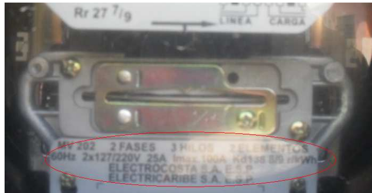
Figura 9. Medidor de energía 1.
