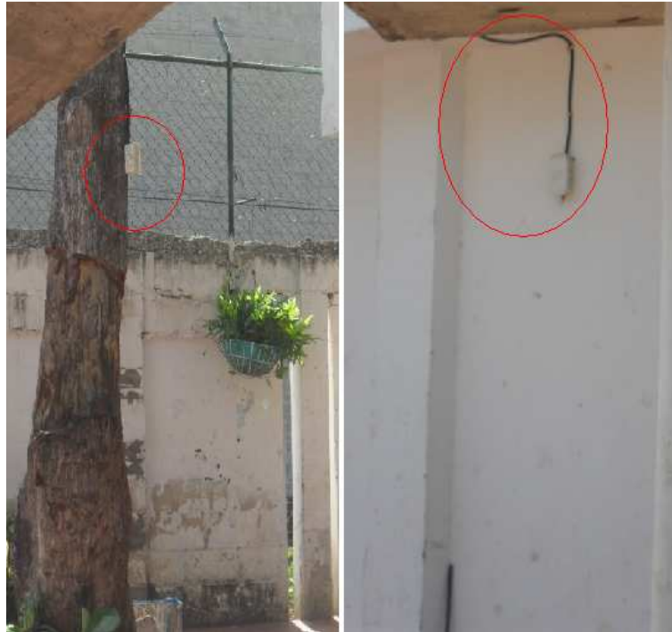
Figura 12. Enclavamientos y utilización inadecuada de tomacorrientes e interruptores de pasillo.
