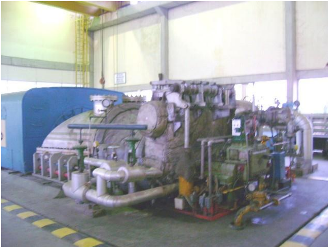
Imagen 10. Turbina a vapor 12.5 MWh del área de servicios industriales de la empresa ABOCOL-Cartagena.
