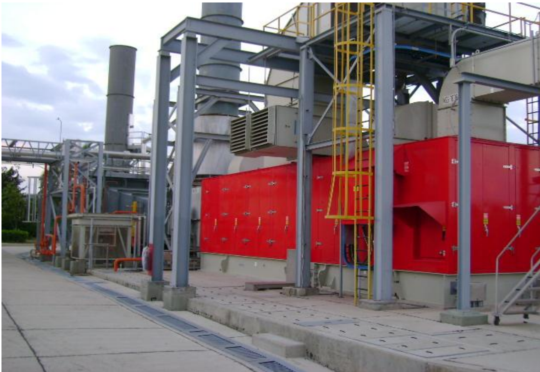
Imagen 11. Bloque cogenerador con turbina a gas TG y caldera recuperadora de calor HRSG del área de servicios industriales de la empresa ABOCOL-Cartagena.
