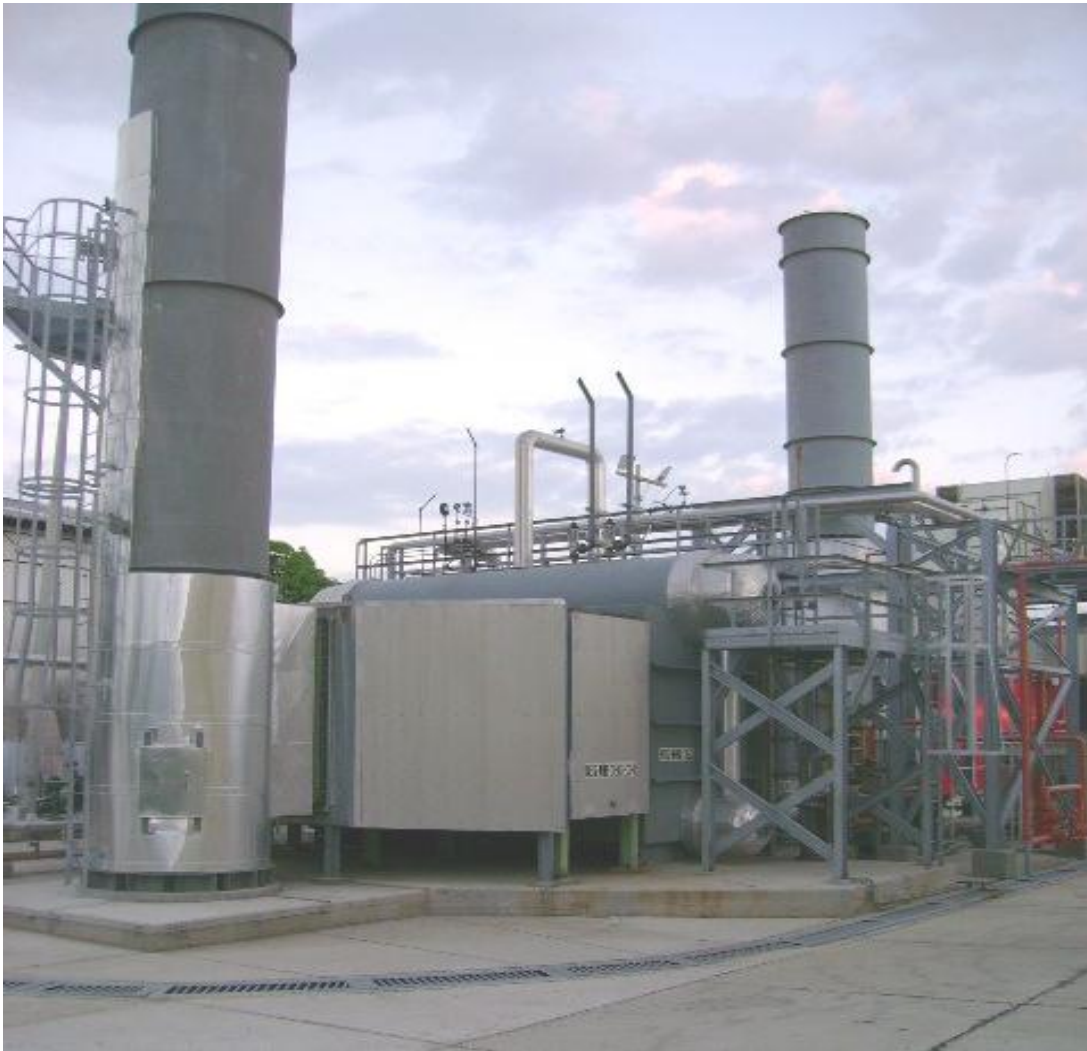
Imagen 7. Caldera HRSG de la empresa ABOCOL-Cartagena
