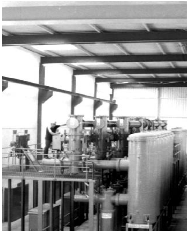
Tomada de GIS de Alta Tensión de Julio Sosa Escalada
