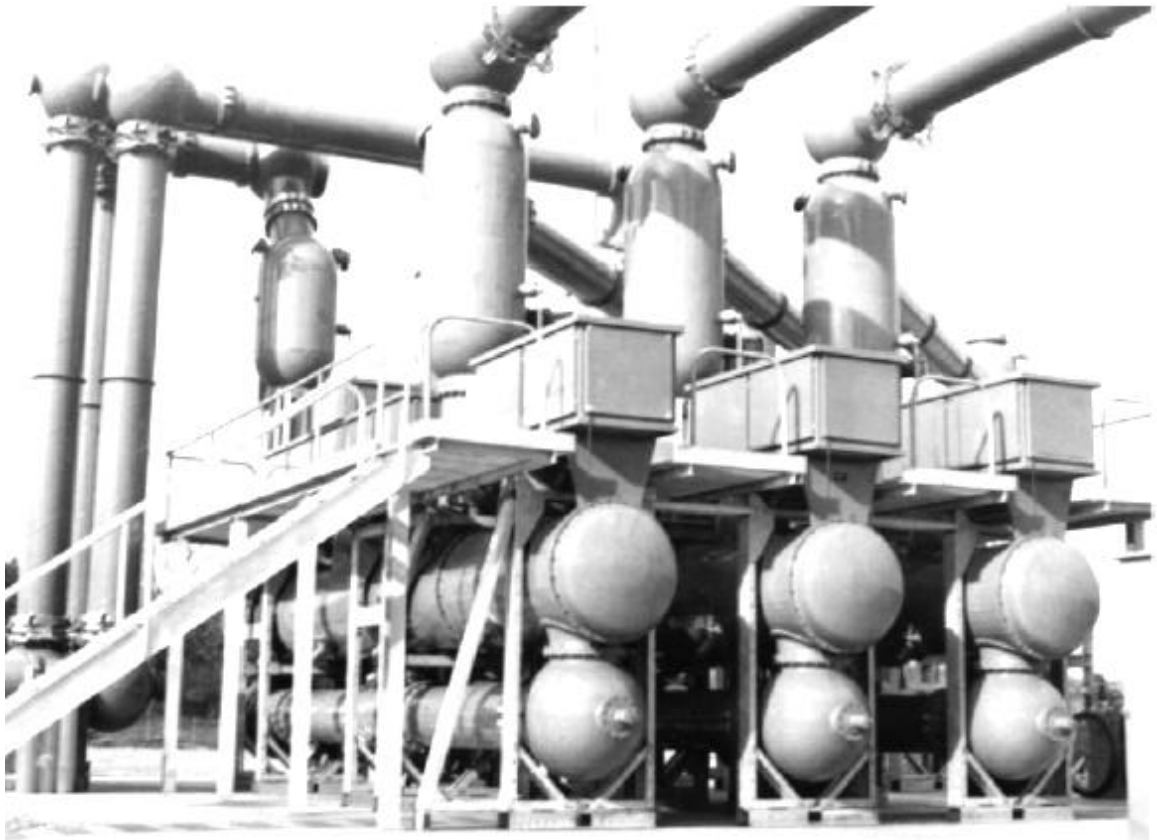
Tomada de GIS de Alta Tensión de Julio Sosa Escalada
