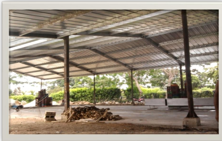
Inicio de Construcción de Planta Especial de Beneficio en el segundo semestre de 2010.
