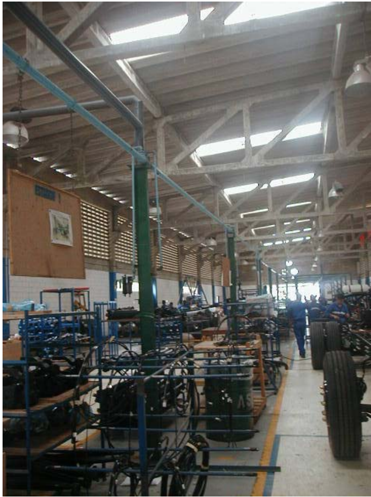
Línea de aire comprimido
