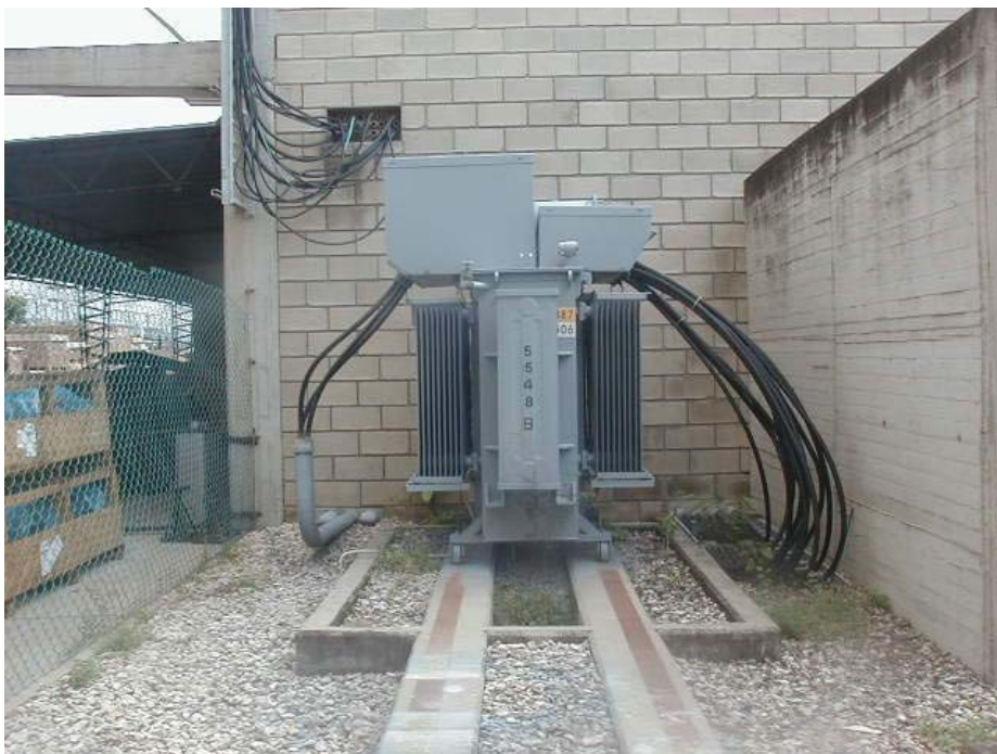
Transformador eléctrico V.2
