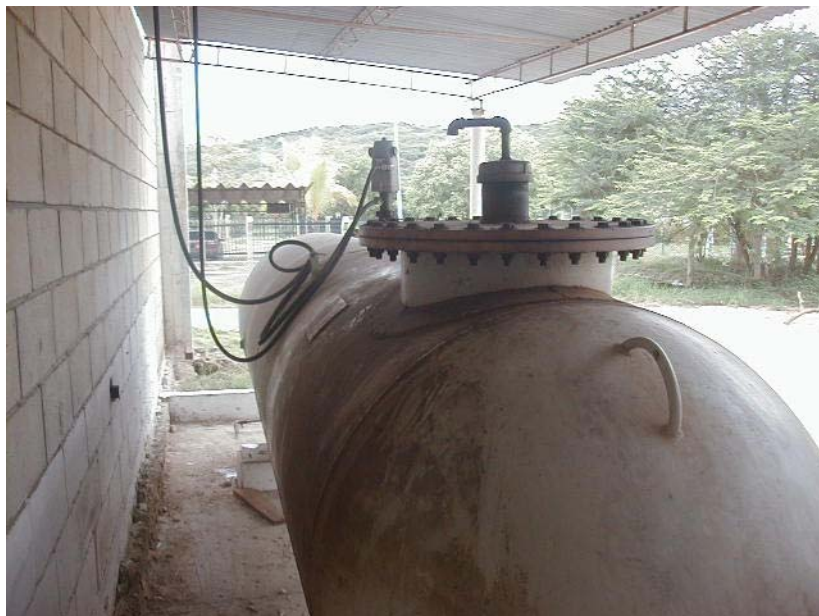
Tanque de combustible
