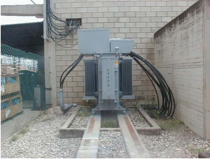
Transformador eléctrico V.1
