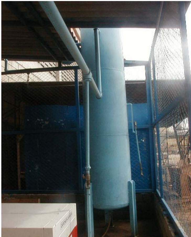
Tanque de aire comprimido
