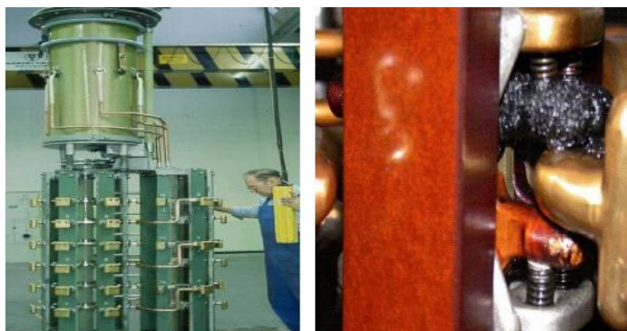
Figura 42. Intercambiador de tomas (izq.) y conexión defectuosa (derecha),
