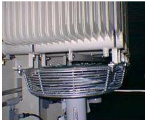
Figura 12. Enfriamiento con aire forzado.
