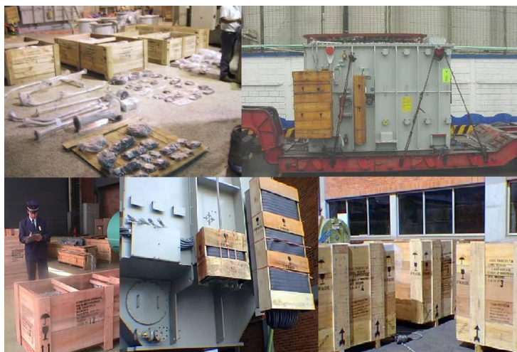
Figura 23. Verificación de elementos, inspección externa y preservación del transformador.
