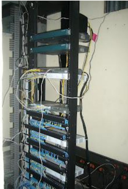
Figura 3. Gabinetes Switches Principales
