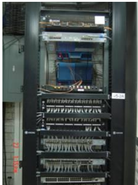
Figura 2. Switches Edificio Padilla
