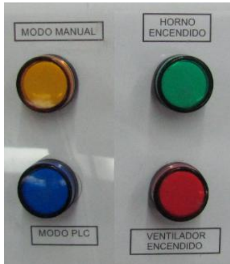
Figura 9. Pilotos de control
