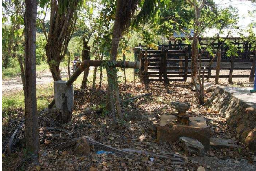
Foto 5. Pozo No.1 fuera de servicio
