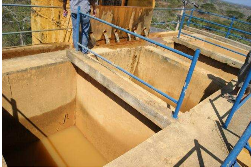
Foto 21. Tanque de Filtros actuales
