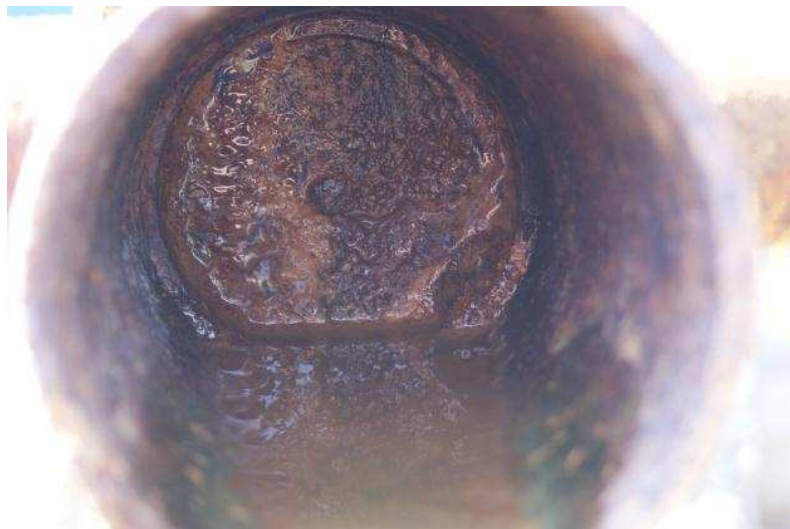
Foto 9. Compuerta de la Válvula en mal estado
