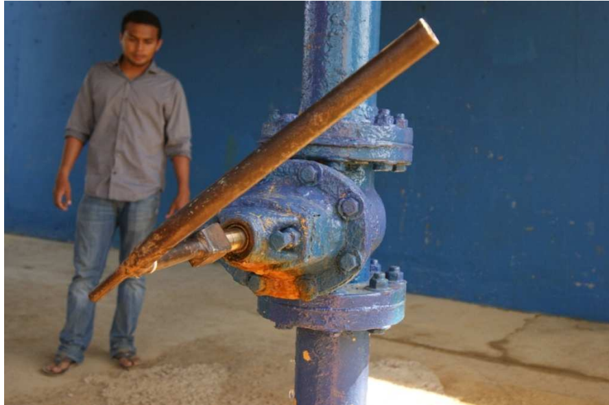
Foto 29. Válvulas de control para el proceso de retrolavado
