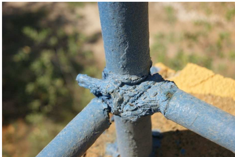
Foto 53. Unión soldada vallas de seguridad
