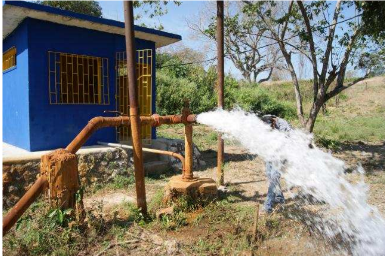
Foto 10. Purga del sistema, control del Hierro sobre el Agua.
