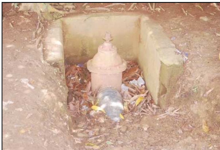
Foto 44. Válvula de bypass averiada
