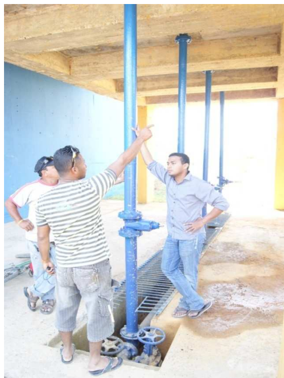
Foto 60. Sistema Hidráulico de retrolavado de filtros
