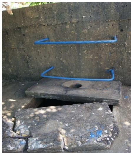
Foto 58. Tapa de acceso a tanque en mal estado
