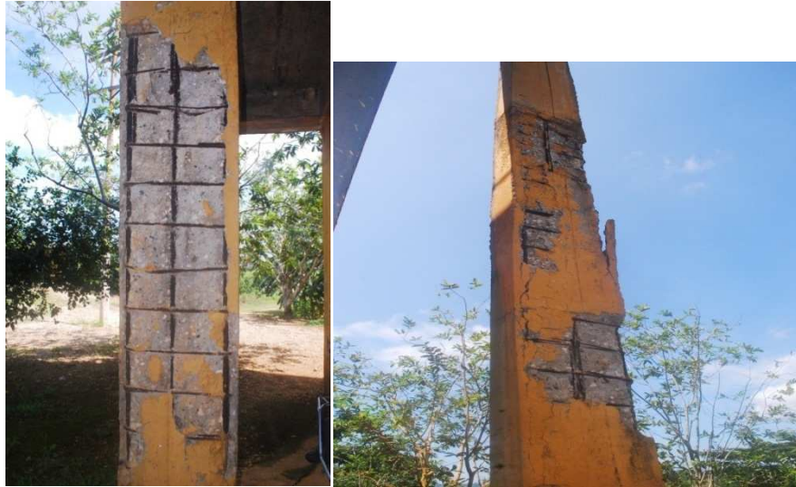
Foto 1. Deterioramiento Estructural. a) Erosión. b) Corrosión Fuente: Autor
