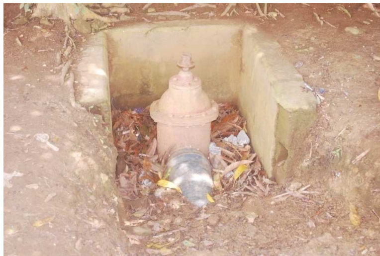
Foto 62. Válvula de Bypass
