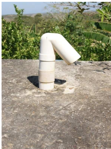
Foto 57. Tubería de aireación adecuada
