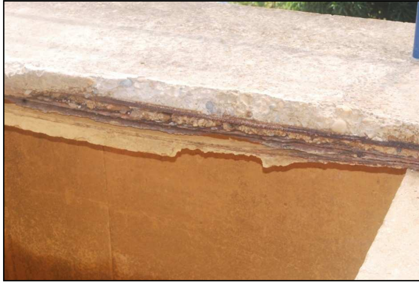
Foto 36. Losa de los tanques destruidas
