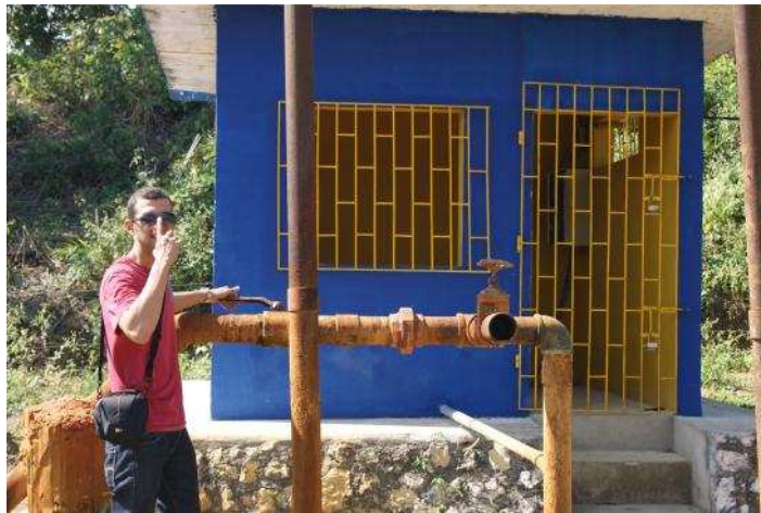
Foto 7. Línea de impulsión del Agua
