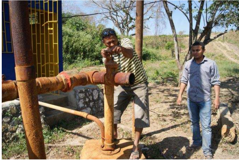
Foto 8. Válvula para control del Drenaje.
