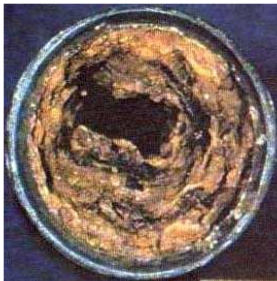
Figura 35. Incrustaciones por productos de corrosión
