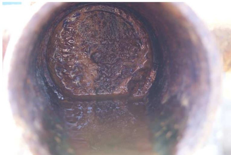
Foto 50. Lodos por presencia de altos contenidos de hierro (óxido de hierro hidratado)
