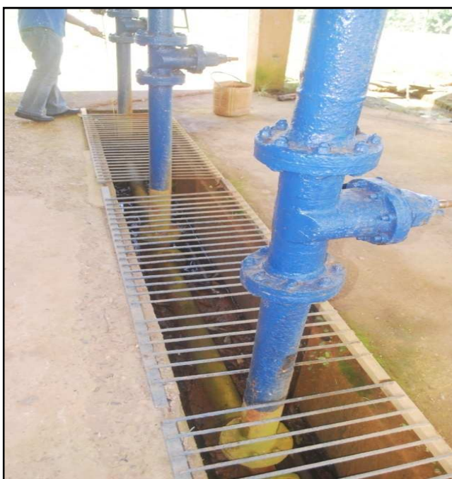
Foto 26. Tubería de 4" para retrolavado y desagüe
