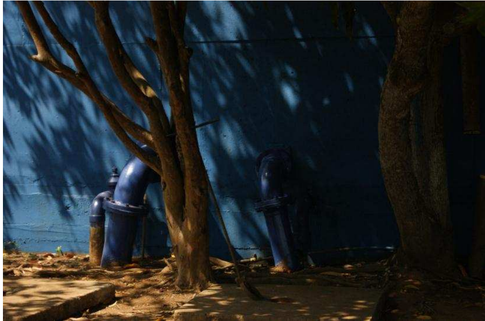
Foto 24. Tuberías de salida de tanques y tuberías de drenaje.
