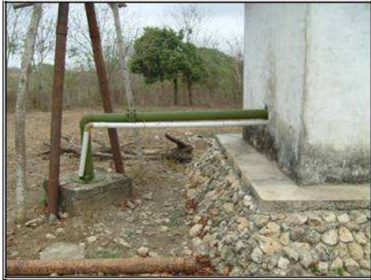
Foto 11. Tubería de impulsión Pozo No. 3
