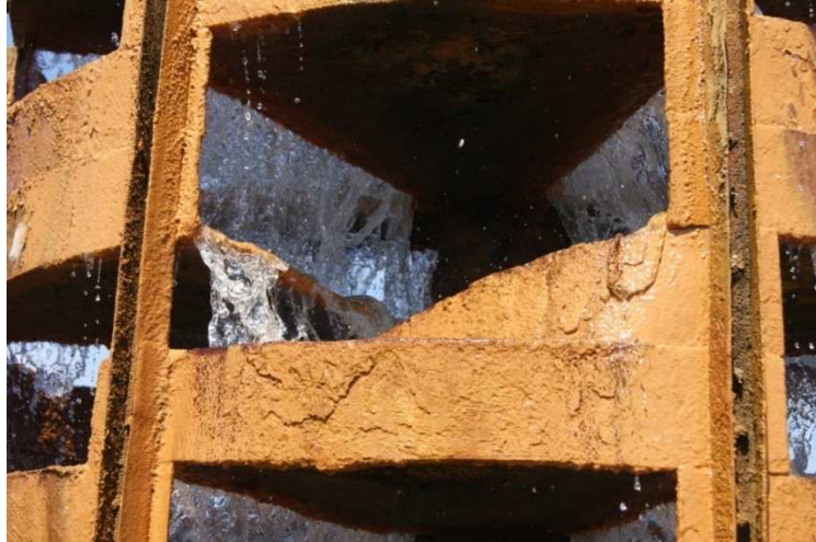
Foto 34. Torre de aireación. Barreras de retención de agua destruidas
