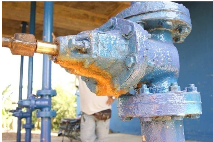
Foto 30. Válvula con fugas debido a problemas con los sellos
