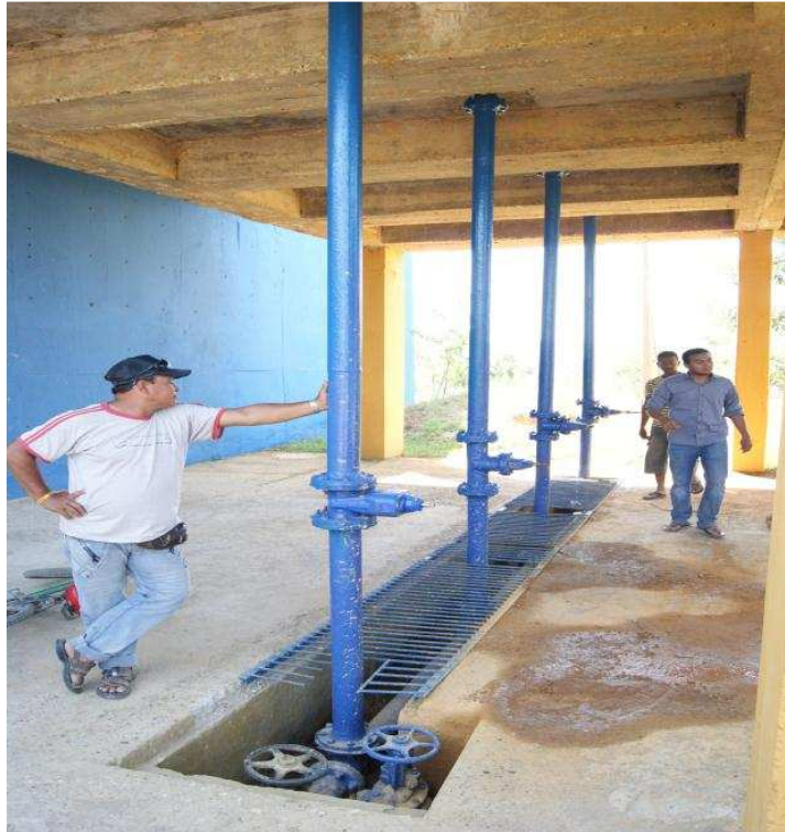
Foto 23. Válvulas de control de drenaje.
