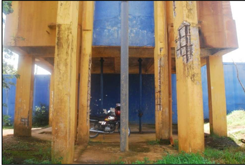
Foto 45. Columnas de soporte de la planta debilitadas
