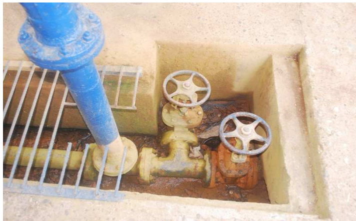
Foto 4. Válvulas de control abandonadas y con vida útil expirada
