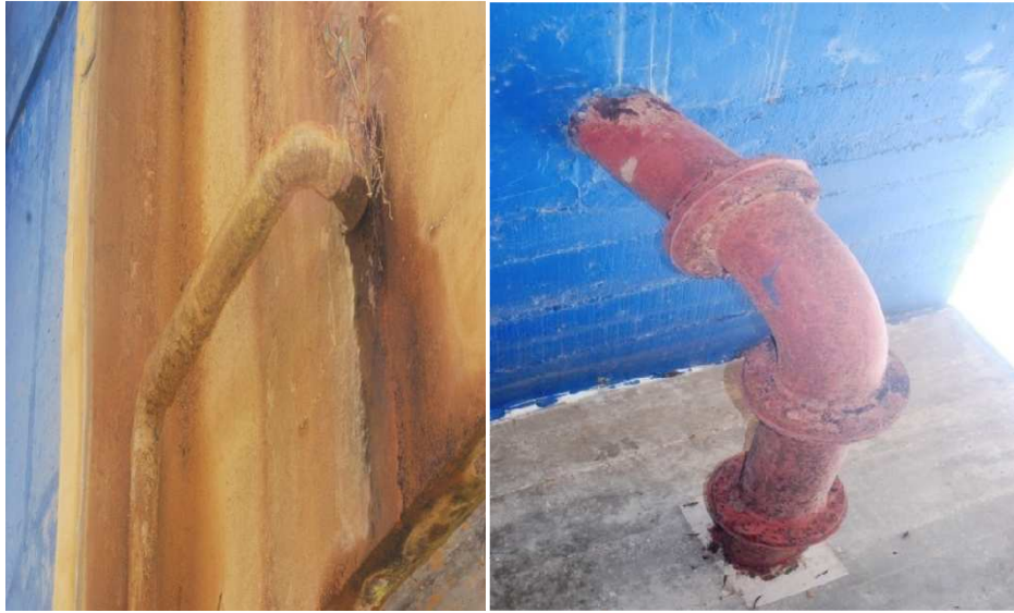
Foto 3. Tubería Corroída y con filtraciones
