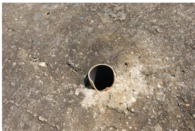
Foto 56. Tubería de aireación rota Fuente: Autor
