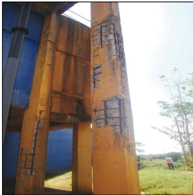
Foto 46. Columna con desprendimiento de material y exposición del refuerzo
