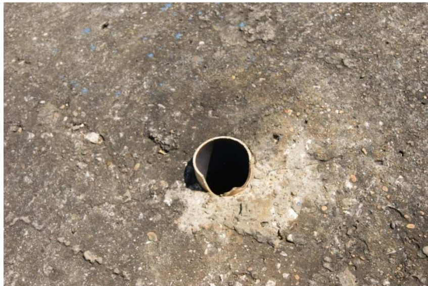
Foto 41. Tubería de aireación tanque de almacenamiento rotas
