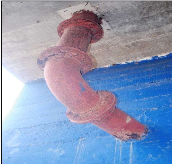
Foto 27. Tubería de transporte de agua filtrada
