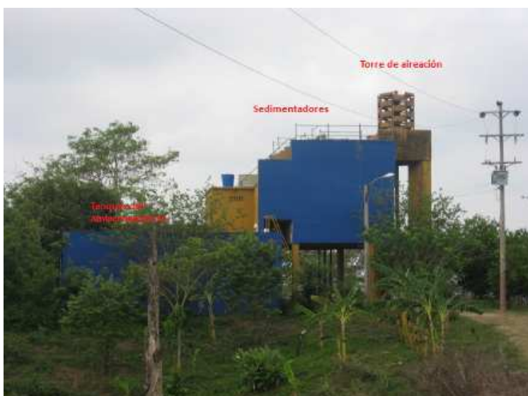
Foto 59. Vista lateral Planta de tratamiento de agua potable
