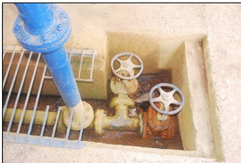
Foto 28. Válvulas de control de entrada y salida de agua
