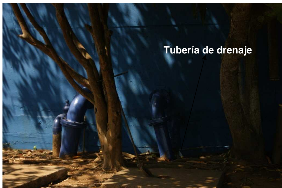
Foto 43. Tubería de drenaje rota
