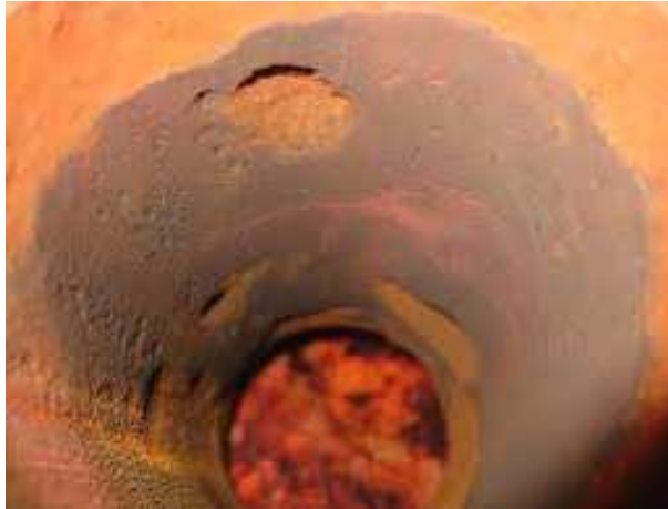
Figura 37. Tubería Corroída internamente con desprendimiento de pared
