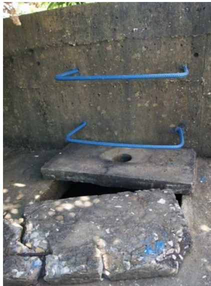
Foto 39. Tapa de entrada a tanques de almacenamiento
