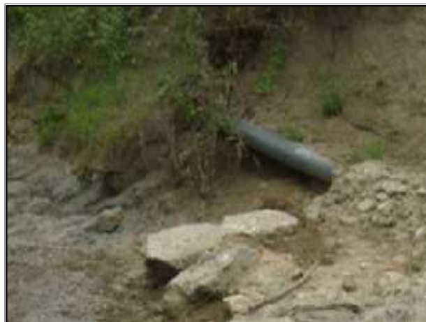
Foto 12. Línea de Aducción
