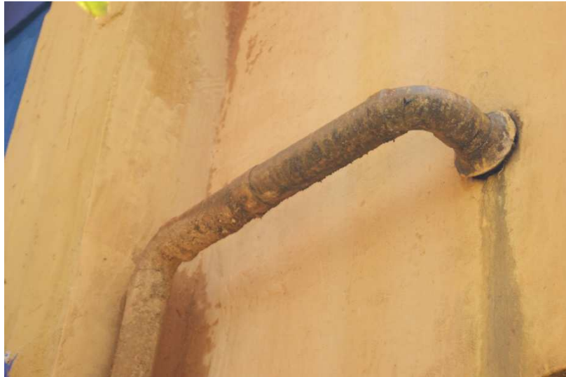
Foto 31. Tubería de drenaje con filtraciones en el pasa muro
