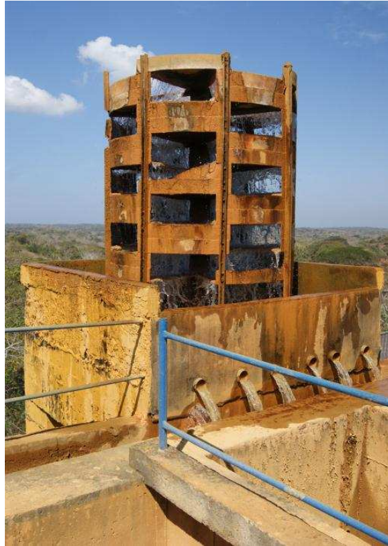
Foto 18. Torre de aireación.
