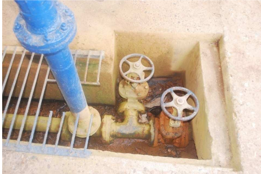
Foto 61. Válvulas de paso de agua y drenaje
