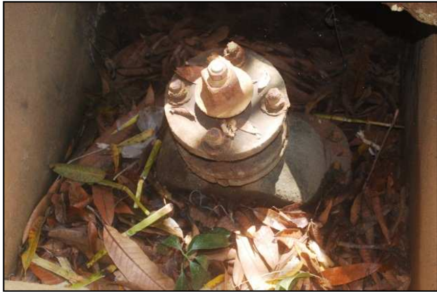
Foto 42. Válvula de descarga de agua tratada la red de distribución
