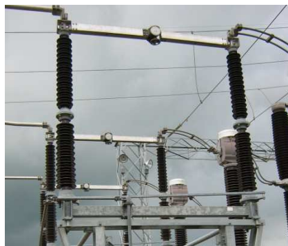
Figura 7. Seccionador de Potencia
