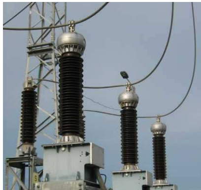
Figura 12. Transformador de potencial
