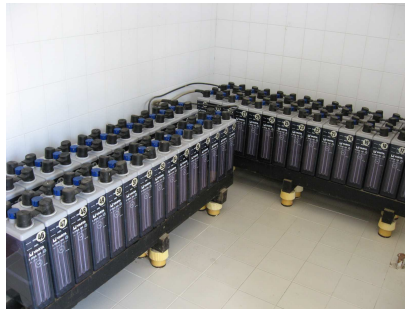
Figura 48. Banco de Baterías
