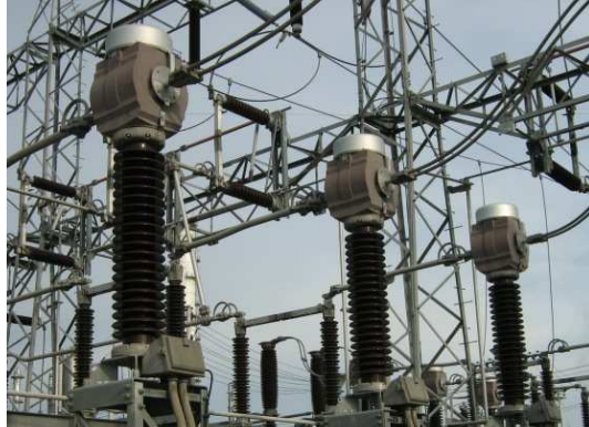
Figura 13. Transformador de corriente
