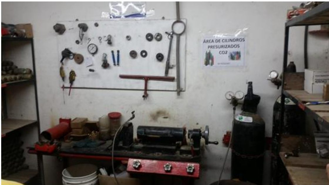
Figura 7. Área de llenado de cápsulas de accionamiento y presurización.
