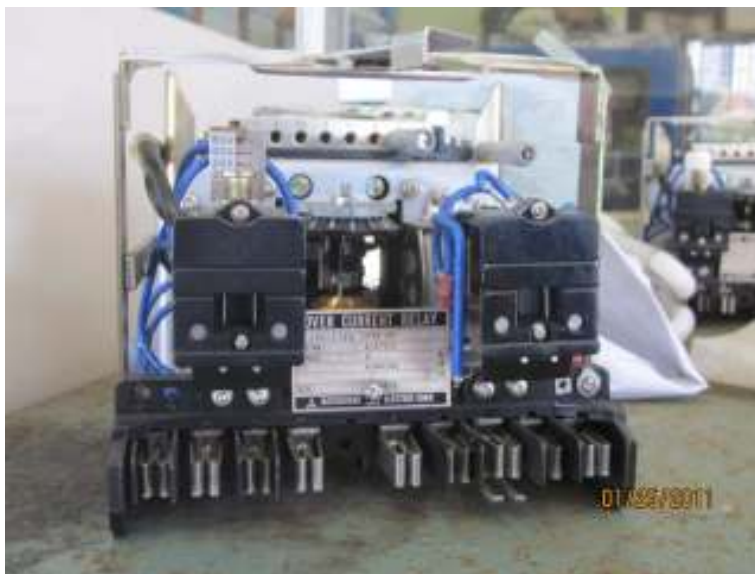
Figura 5. Foto Relé 50/51 actualmente instalado
