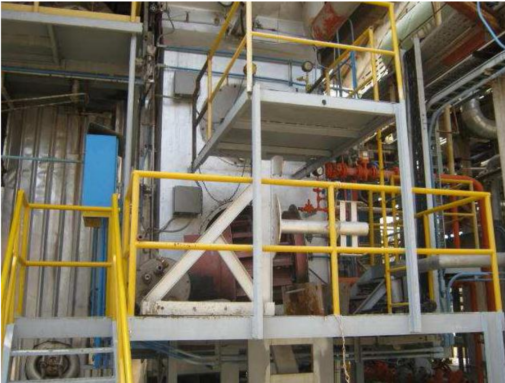
Fig. 26 Caldera NSG -305 Abocol Tomada en la empresa Abocol S.A
