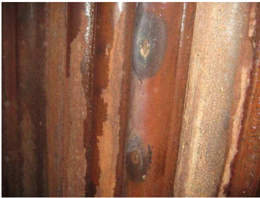
Fig. 27 Falla por pitting, en caldera de Abocol Tomada en Abocol
