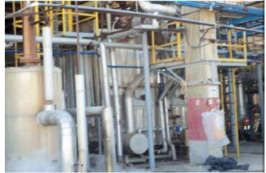
Fig. 21 Caldera 103 de Abocol
