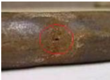
Fig. 9. Falla por pitting
