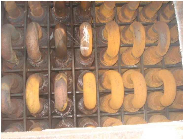
Fig. 30 Falla en economizador de una caldera de Abocol Tomada de Abocol S.A
