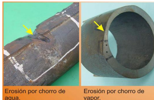
Fig. 10 - Falla por erosión Tomada de:
