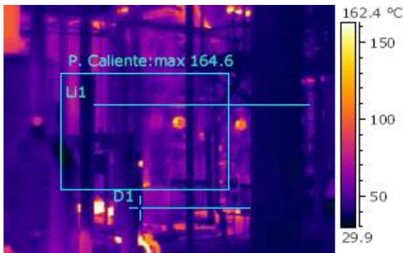
Fig. 20 Inspección termográfica en Abocol
