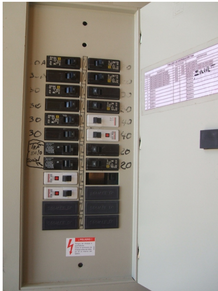
Figura 4. Tablero de Distribución TAA
