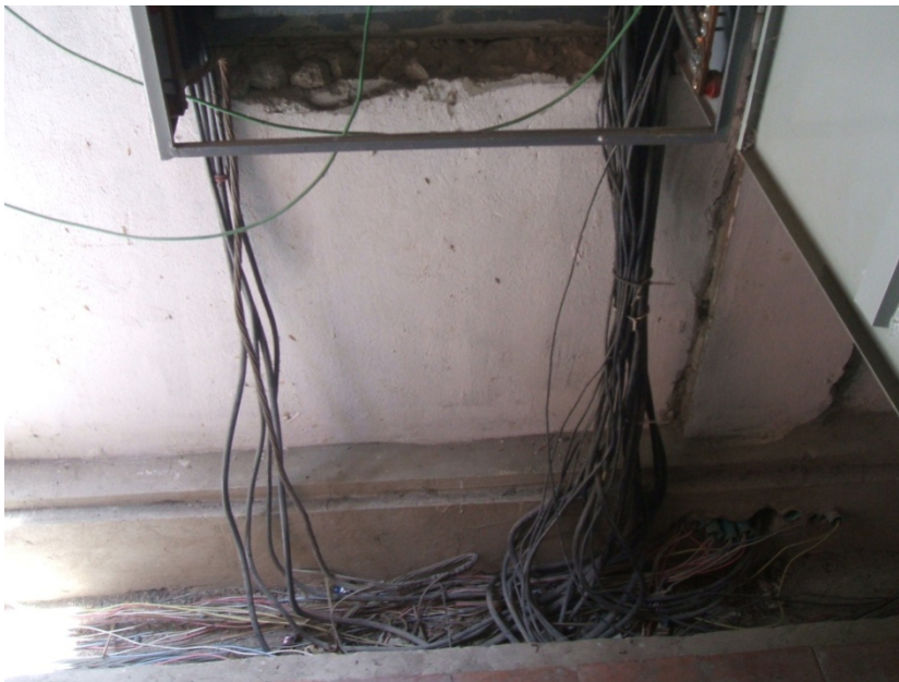
Figura 6. Cables de entrada y salida del tablero general TGB sin ninguna clase de protección.
