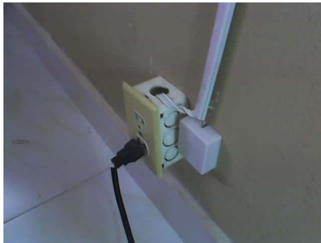
Figura 9. Tomacorrientes sobrepuestos, instalaciones eléctricas e instalaciones telefónicas canalizadas en el mismo ducto.
