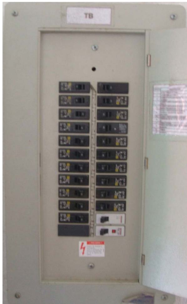
Figura 3. Tablero de Distribución TB
