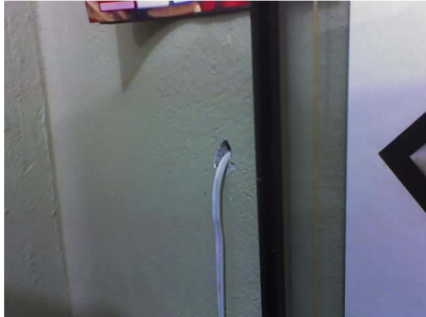
Figura 8. Cordones portátiles sin canalización
