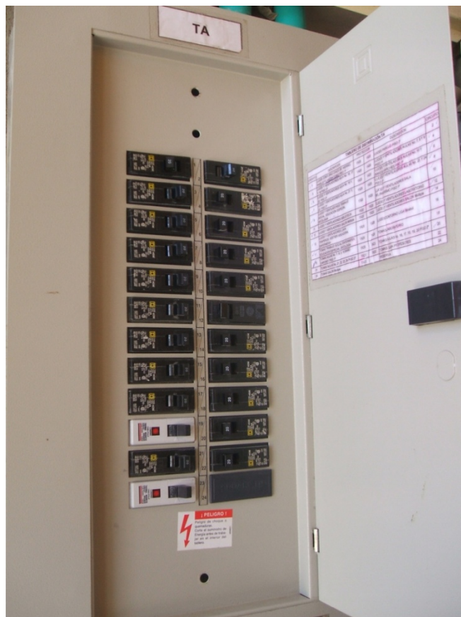
Figura 2. Tablero de Distribución TA
