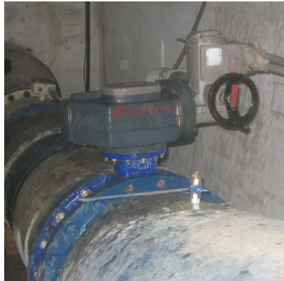
Figura 3: Actuador AUMA en tubería de la red de ACUACAR
