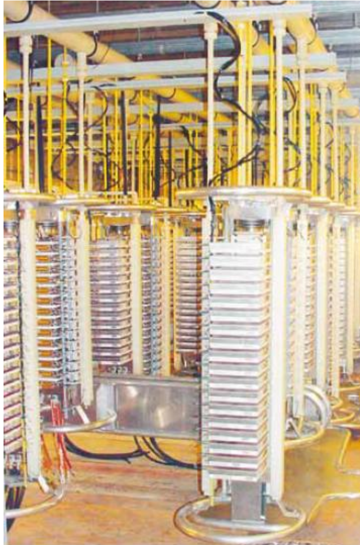
Figura 5-33. Fotografía de las válvulas de IGBT. Fuente: “STATCOM replaces critical urban generation for voltage control and stability”, ABB AB FACTS. June 2010.
