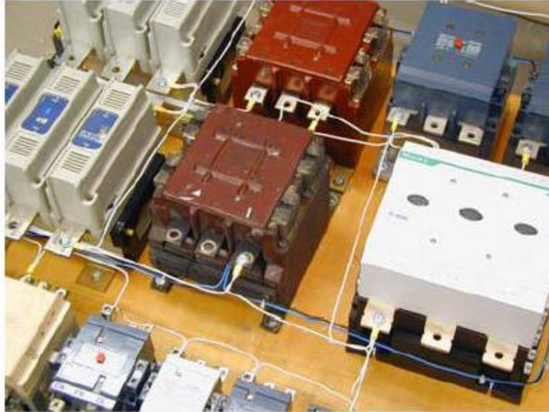
Figura 18. Algunos contactores utilizados en la prueba.
