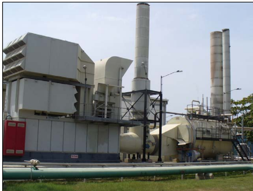
Figura 1.7. Central de cogeneración Biofilm S.A.
